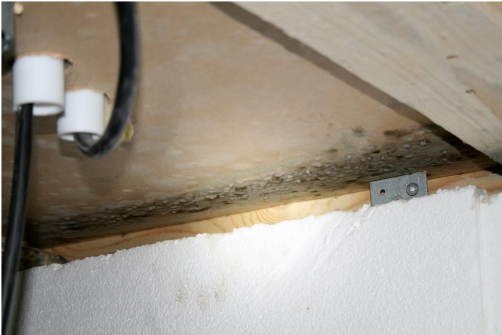
Kuva ennen korjausta.
