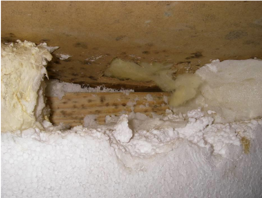
Kuva talotehtaan korjauksen jälkeen. Puhdistus tehty puutteellisesti. Mikrobikasvusto on peitetty uretaanilla.
