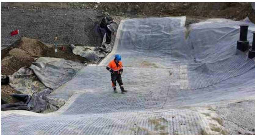
Kilpisjärven tullin uuden liikennealueen hulevesiä varten rakennettiin nykyvaatimusten mukaiset pohjavesisuojuukset kesällä 2016. Kuva: Tommi Laukkanen
