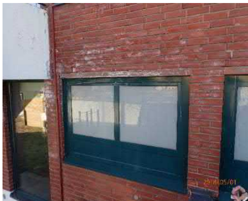
Kuva 10. Rapautumia itäsivun ikkunapalkissa vaurioita
