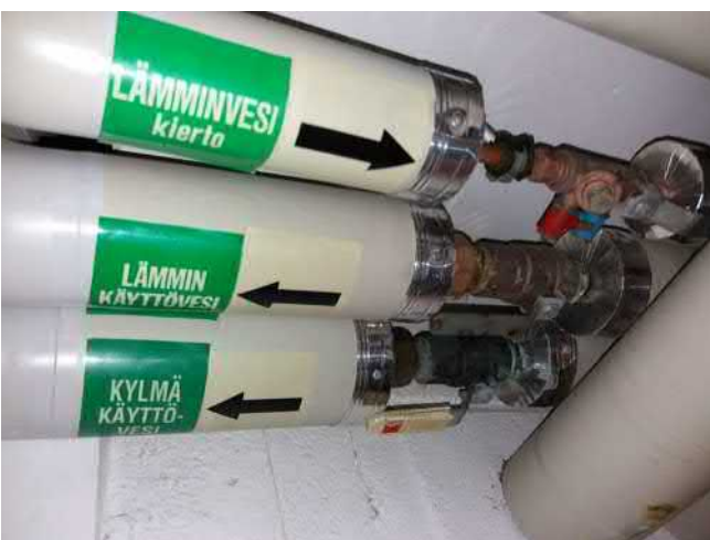
(kuva 5. käyttöveden sulku- ja linjasäätöventtiilit)
