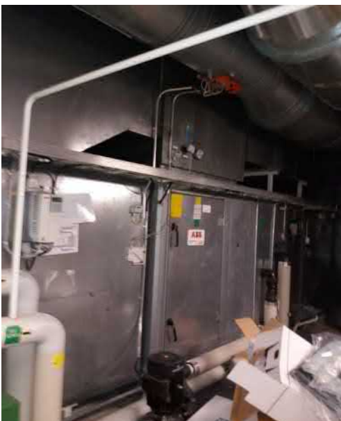
(kuva 11. iv-kone TK02 iv-konehuoneessa)
