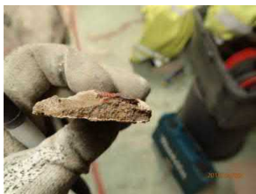
Kuva 86. Betoni on läpi karbonatisoitunutta.
