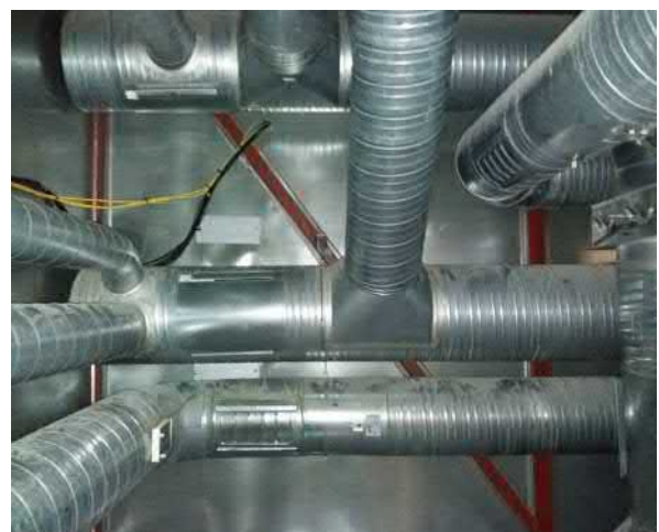
(kuva 12. iv-kanavointeja konehuoneessa)
