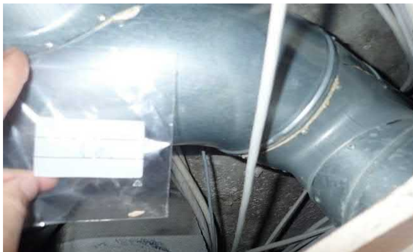
Näyte 7. Bitumikermi. Ulkoa, porrastanteen pintavalun alla oleva kermi. Ei sisällä asbestia.
