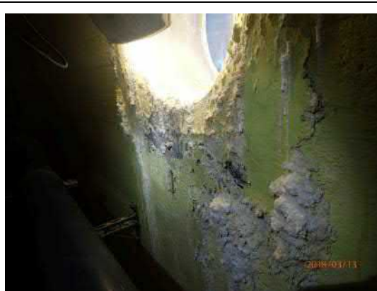
Kuva 74. Vuotovesijälkiä ikkunan läpiviennillä
