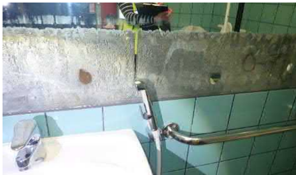
Kuva 26. Peilin vauriot wc-tiloissa
