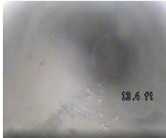
(kuva 20. miesten pesuhuoneen poistoilmakanavat sisäpuolelta kuvattuna)
