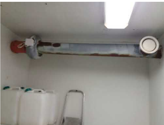
(kuva 23. kellarin kemikaalivarastotilan poisto-) puhallin ja kanavisto)
