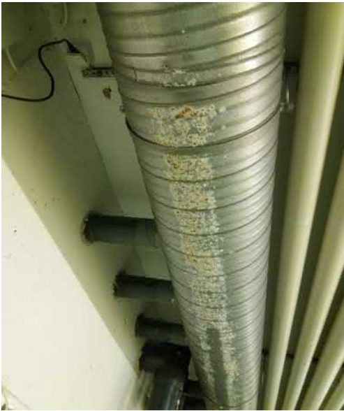
(kuva 13. kellarin huoltokäytävällä allasosaston poistokanava ulkopuolelta kuvattuna)
