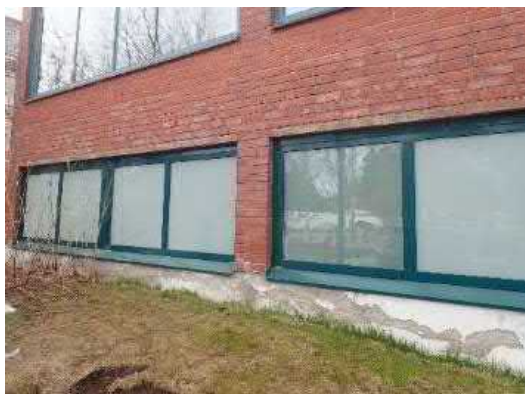
Kuva 8. Vaurioita sokkelin pinnoissa
