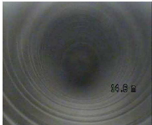
(kuva 16. allas osaston tuloilmakanava piennopeuslaitteelle sisäpuolelta kuvattuna)
