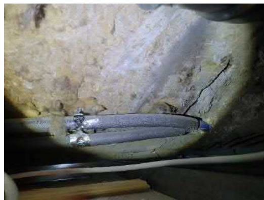
Kuva 43. Suojaamattomia villoja IV-kanavistossa
