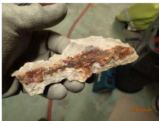
Kuva 85. Pala irrotettu, teräkset menetetty.
