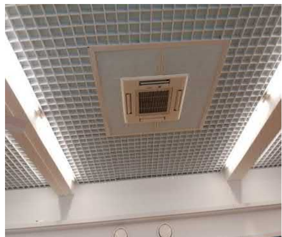
(kuva 24. jäähdytyksen puhallinkonvektori kuntosalin tiloissa)
