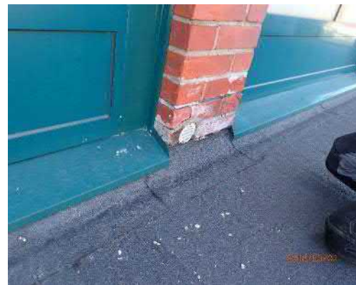
Kuva 11. Itäpäädyn katoksen liitos, vaurioita
