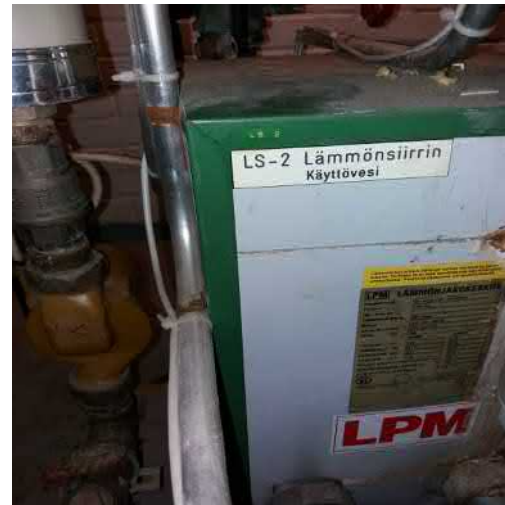
(kuva 2. käyttöveden lämmönsiirrin)
