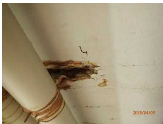
Kuva 84. Korroosio vaurio välipohjan alapinnassa.
