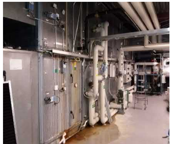
(kuva 10. iv-kone TK01 iv-konehuoneessa)
