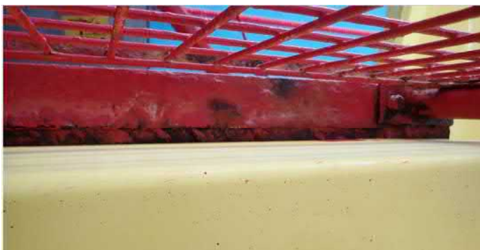
Kuva 6. Portaikon reuna alueen vaurioita
