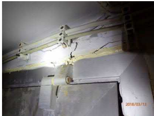
Kuva 78. Halkeamia laguunialtaan tasausaltaan tarkastusluukun yläpuolella.
