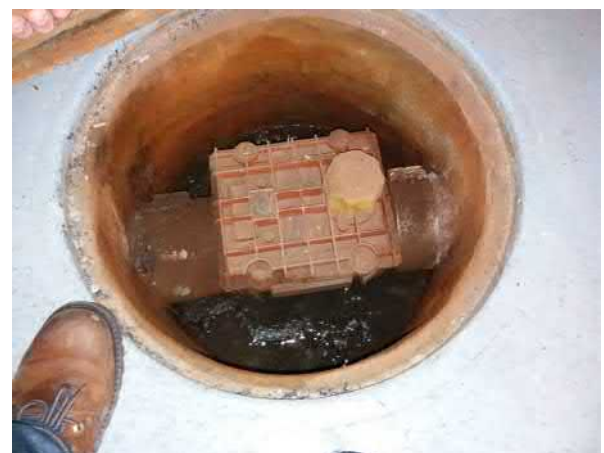
(kuva 6. sadevesiviemärin padotusventtiili)
