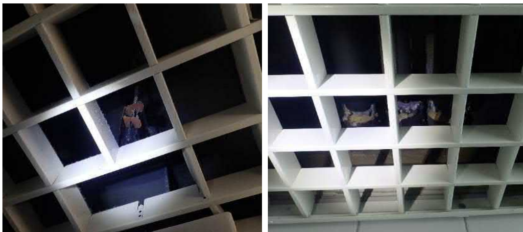
Kuva 18. Ritiläkaton kiinnikkeet ruosteessa Kuva 19. Putkieristeiden eristeiden päät näkyvissä
