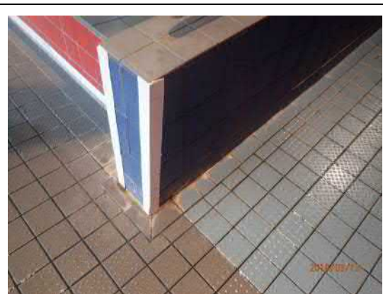
Kuva 60. Seinän ja lattian liitoksessa teräkset ovat ruostuneet.
