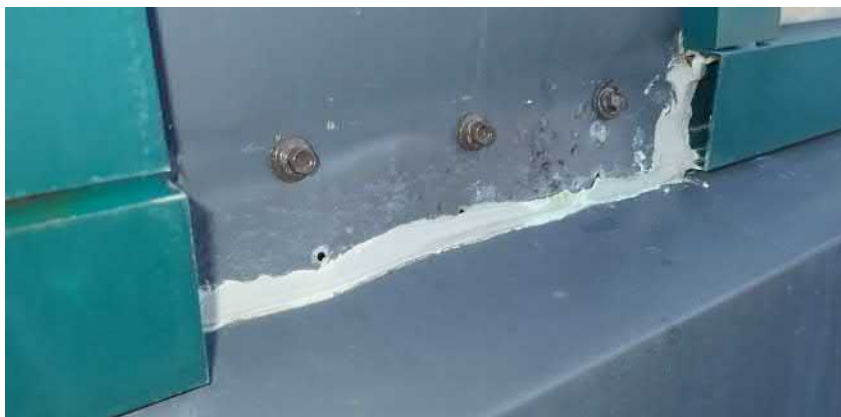
Kuva 14. Vanhoja ruuvien paikkoja tiivistämättä
