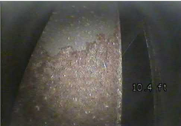
(kuva 21. iv-koneen TK01 sisällä lamelliäänenvaimentimissa ruostetta)
