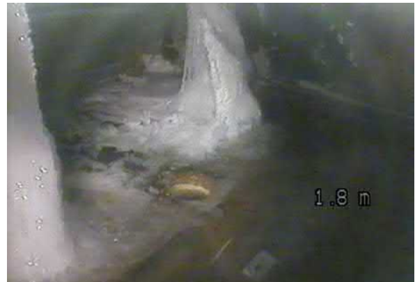
(kuva 22. TK01 koneen sisällä jäätä)
