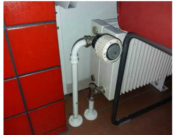
(kuva 4. aulatilän patteriventtiili)
