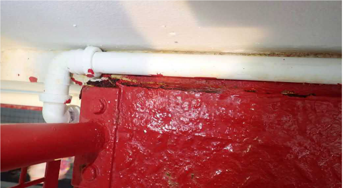
Kuva 7. Portaikon reuna alueen vaurioita
