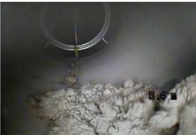
(kuva 17. ryhmäliikuntatilan tuloilmakanava)
