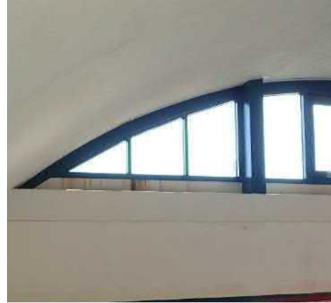
Kuva 45. Valumajälkiä kaari-ikkunoiden alla
