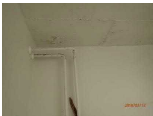
Kuva 80. Suolahappuhuoneen ylänurkassa on viitteitä teräskorroosiosta.
