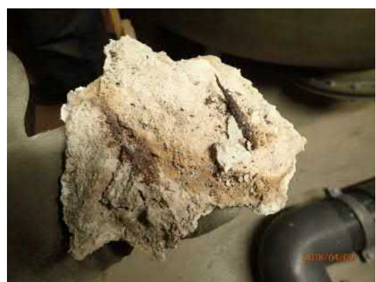
Kuva 83. Pala irrotettu, teräkset menetetty täysin.
