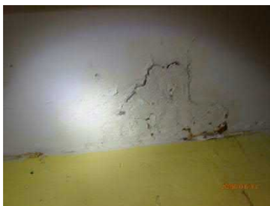
Kuva 75. Hyppytornin kohdalta pala lohkeamassa holvista.
