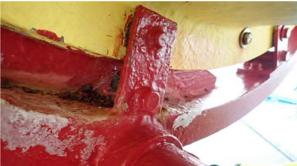
Kuva 4. Kaarella ja kiinnikkeissä korroosiovaurioita
