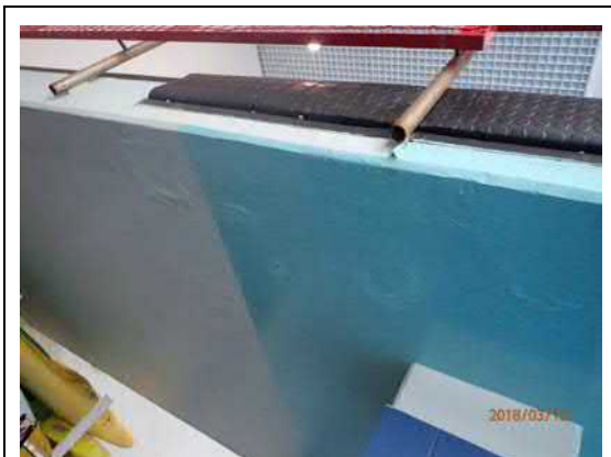
Kuva 62. Hyppytornin 3 taso, alapinta. Maton kohdalla rakenteen alapinta on kostea. (Matto peittää laatan ohennuksen).
