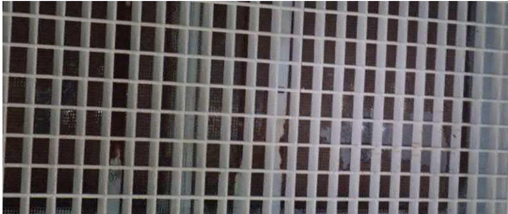
Kuva 33. Allasosaston katto. Ruosteinen verkko valkoisen ritilän takana
