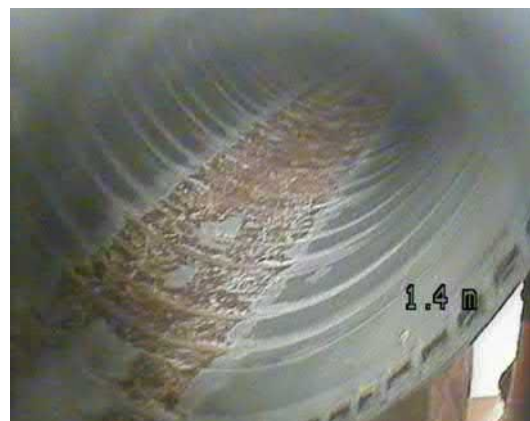
(kuva 18. allasosaston tuloilmakanava ikkunapuhallukselle kellarin huoltokäytävällä)
