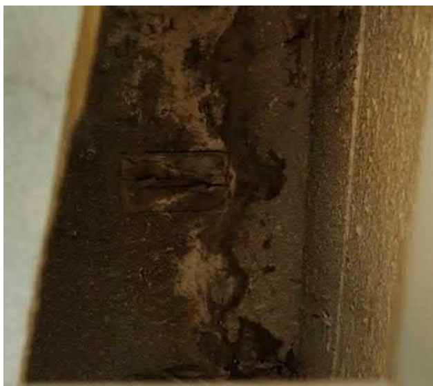
Kuva 6. Kosteusvaurioita puukappaleen ympärillä
