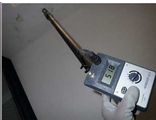
Kuva 5. Ei merkkejä kohonneesta kosteudesta
