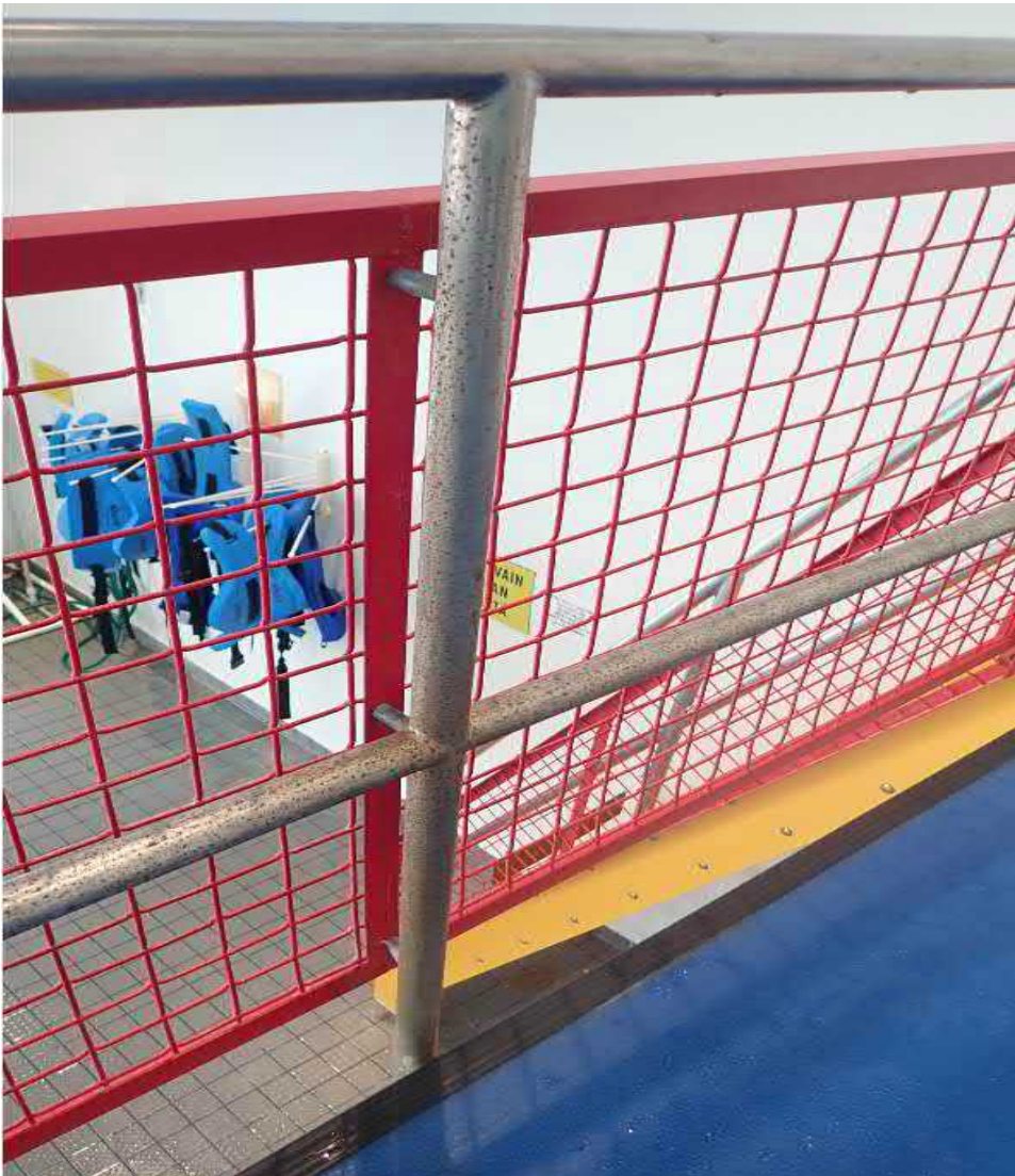
Kuva 12. Kaiteiden pinnassa runsaasti korroosiota
