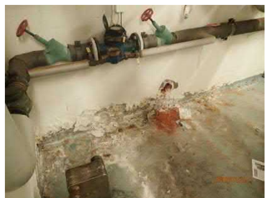
Kuva 81. Lämmönjakohuoneen seinän ja lattian liitos, vanhan vuodon vauriojäljet.
