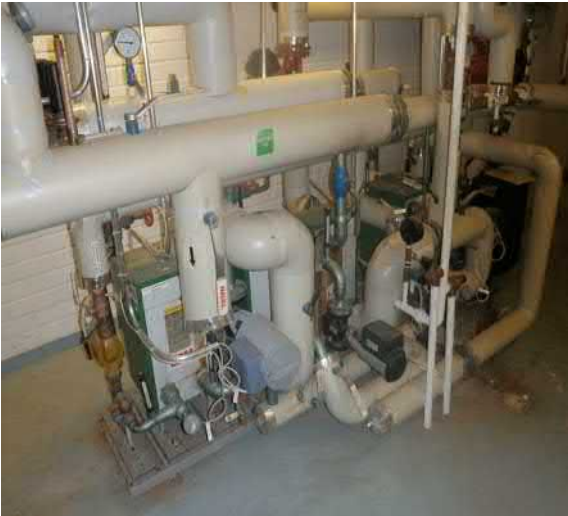
(kuva 1. kaukolämmön alajakokeskus)
