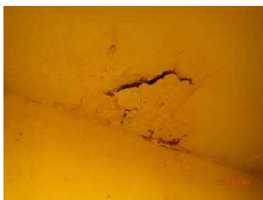
Kuva 82. Hyppytornin päädyssä välipohjan alta pala lohkeamassa.
