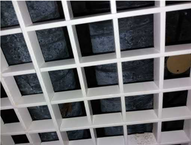
(kuva 19. miesten pesuhuoneiden iv-kanavat ulkopuolelta kuvattuna ritiläkaton sisällä)
