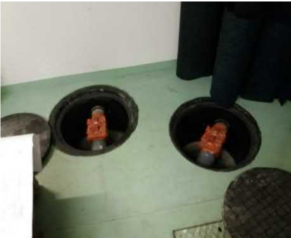
(kuva 7. jätevesiviemärin padotusventtiilit)
