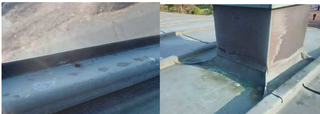
Kuva 15. Kaariosalla kohonneita nauloja
