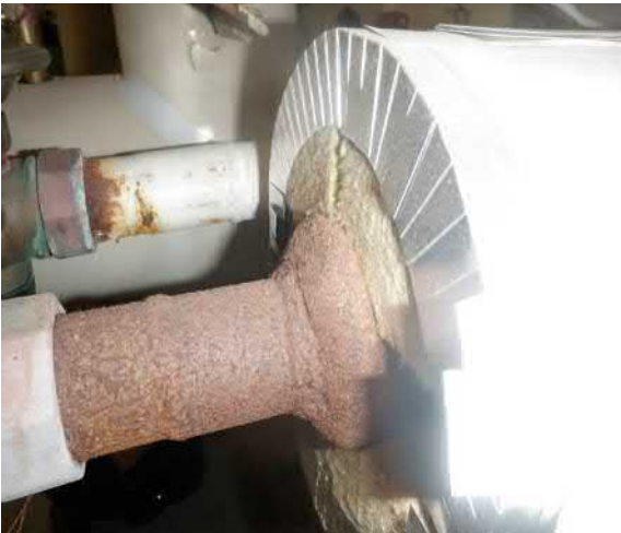
(kuva 3. ruostekorroosiota KL-johdoissa)
