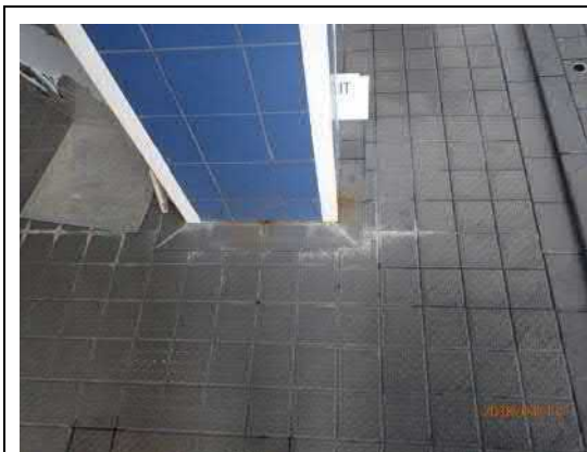
Kuva 59. Pilarin ja lattian liitoksessa teräkset ovat ruostuneet.
